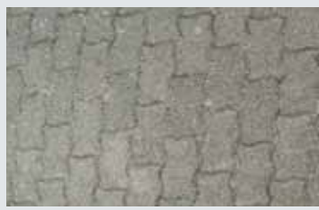
Betonsteine ohne Fugenverguss
